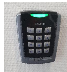
Adgangsregulering kan i mange tilfælde ske via AAU-kortet
