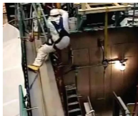
Foto 1. Stilladsmontør falder fra stillads, men reddes af sit faldsikringsudstyr (fra overvågningskamera).
